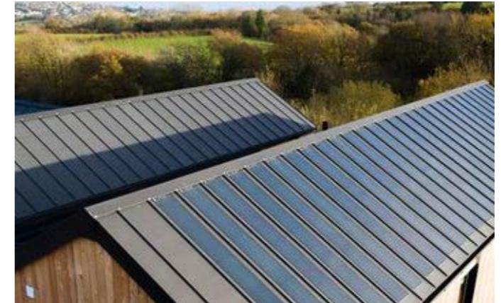
geïntegreerde zonnepanelen in het dakvlak
