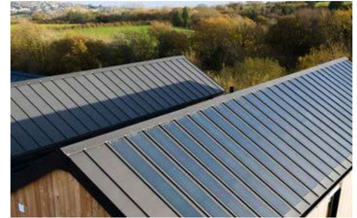
geïntegreerde zonnepanelen in het dakvlak
