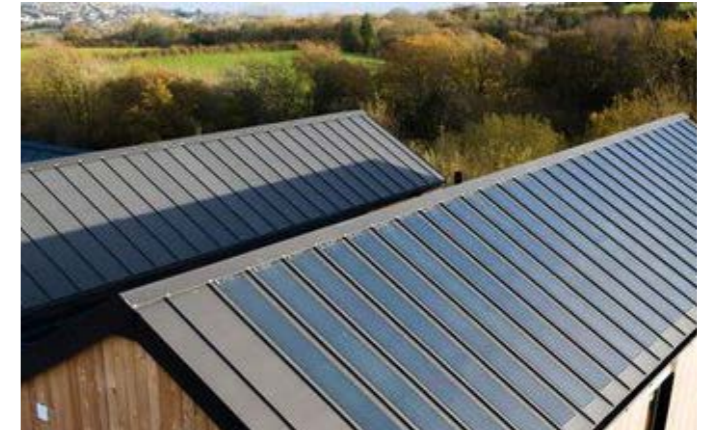
geïntegreerde zonnepanelen in het dakvlak
