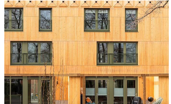
kozijnen / goten / overige details gebruiken een kleurtint uit het palet. deze vormt geen groot contrast met de gevelbekleding.
