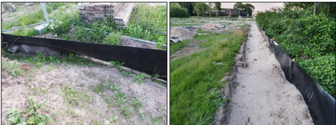
Figuur 3 Een incorrect geplaatst amfibiescherm (links). Een correct geplaatst amfibiescherm (rechts). Deze dienen minimaal 10 cm ingegraven te zijn (bron foto's: Blom Ecologie).
